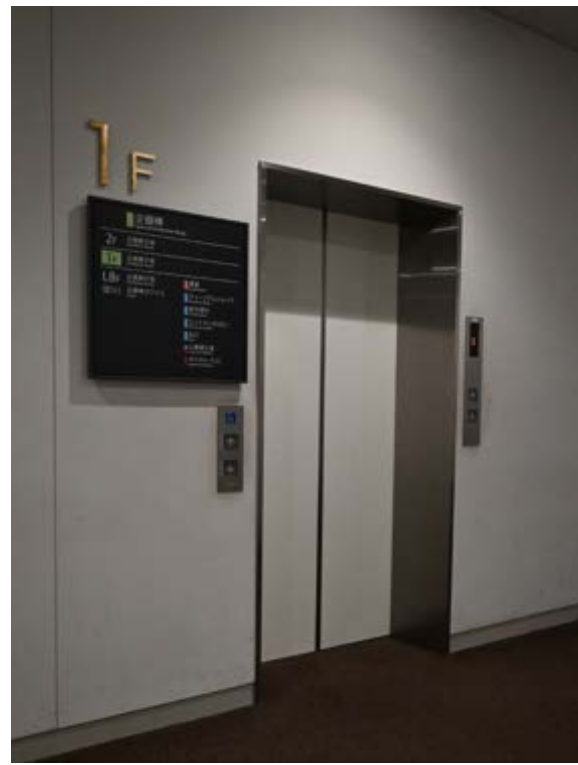
エレベーター（企画棟1階）
