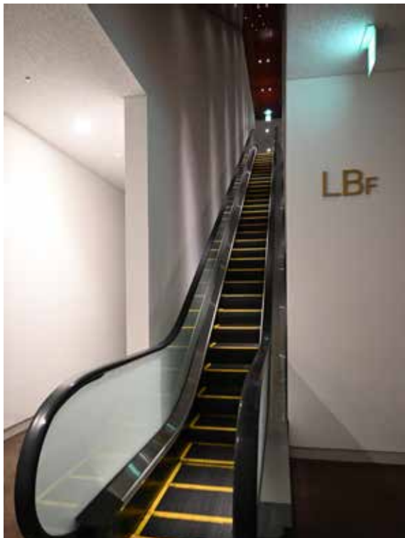
エスカレーター（企画棟ロビー階）
